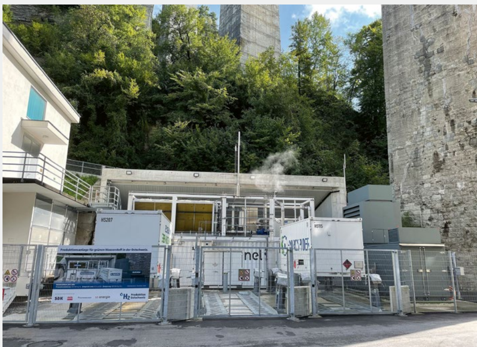
Fig. 3 Anlage der Wasserstoffproduktion Ostschweiz beim Wasserkraftwerk Kubel in St. Gallen.
