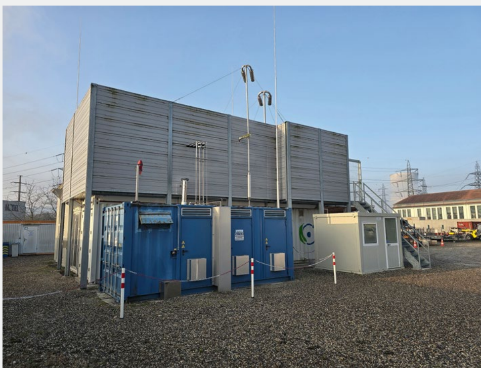
Fig. 4 Elektrolyseur und Kompressor der Wasserstoffproduktionsanlage von Hydrospider in Niedergösgen.
